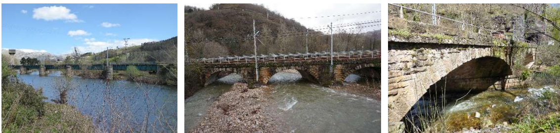
Puentes del ferrocarril de Santander a Alar del Rey (1852 a 1866) sobre el río Besaya: de Somahoz (modificado en 1945), de Las Fraguas y del Rey en Santa Olalla (LVC).
